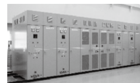
京極発電所 ロードセンター
